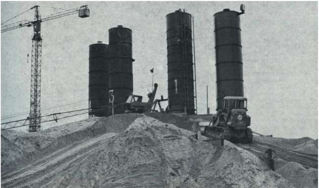
Figure 29: La centrale à bétons
