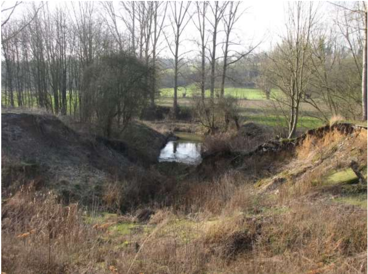
Figure 15 : la large brèche qui s'est ouverte dans a digue du canal et qui a laissé s'échapper toute l'eau dans la Sennette qui n'en demandait pas tant !
